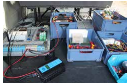
Die Leistungen der Windgeneratoren wurden vor den Batterien abgegriffen. Die Werte sind als blaue Punktwolken sichtbar.
