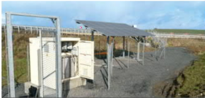
Stromversorgung einer Mess-Station zur Geschwindigkeitskontrolle
