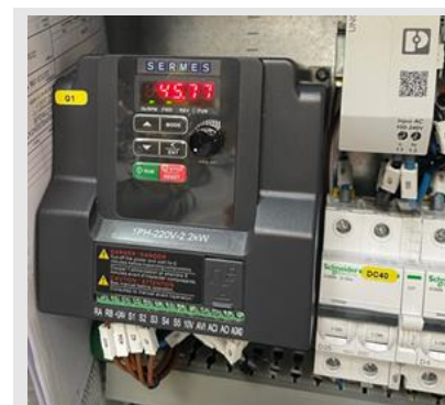
El variador de frecuencia en la caja eléctrica.
