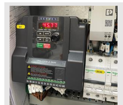
Le variateur de fréquence dans le coffret électrique.
