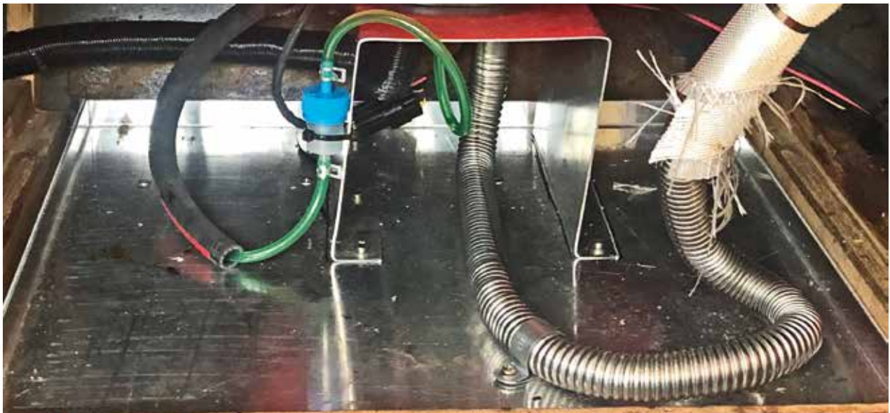
Nicht perfekt aber zumindest mit einer Aluminiumwanne, die auch zur Wärmeverteilung des Abgas-Wellrohres dient. Die weitere Führung in der Nähe von Holzeinbauten ist zusätzlich mit Glasfaser-Isolation wärmedämmend.
